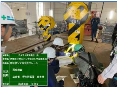
天井クレーン65tフック
