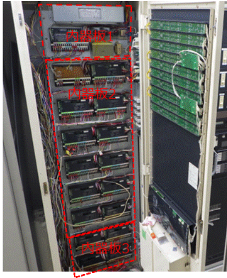
自動火災受信機盤内
