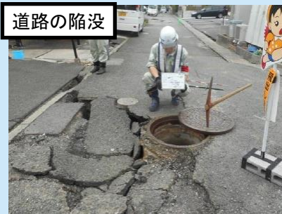
道路の陥没 平成28年熊本地震(熊本県熊本市)
