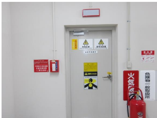
＜電気室（入室側）から見た扉写真＞
