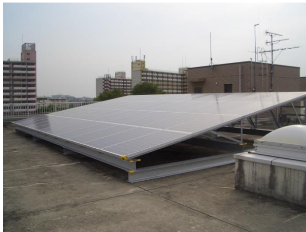
太陽光発電設備（泉北下水処理場）
