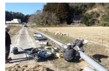
下水を処理場にする圧送管の被災現場（珠洲市）
