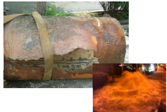
南区若松台（口径800mm） 大規模漏水事故（2012年）
