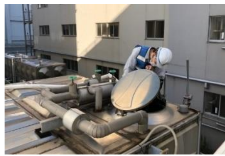
▲貯水タンクへの給水
