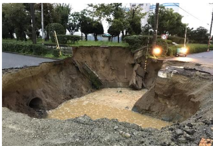
今池水みらいセンター敷地内陥没状況 (H29.10.25)
