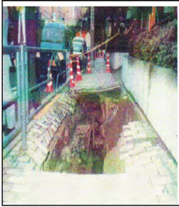
管きよの破損による道路陥没
