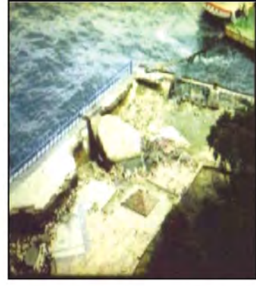
処理場施設被災による水域の汚染
