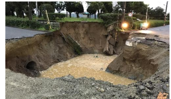
堺市公共下水道管の破損事故 (平成29年度・今池水みらいセンター)
