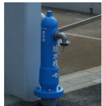
災害時給水栓写真(出典:仙台市)
