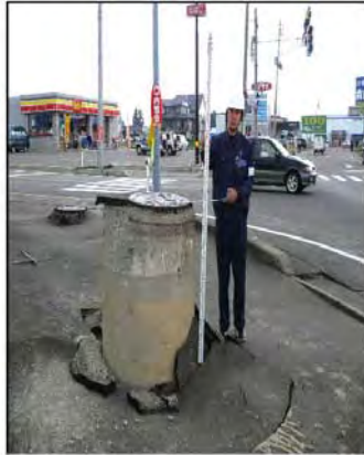
液状化によるマンホール浮上
