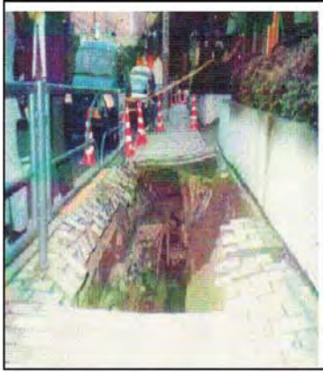
管きよの破損による道路陥没
