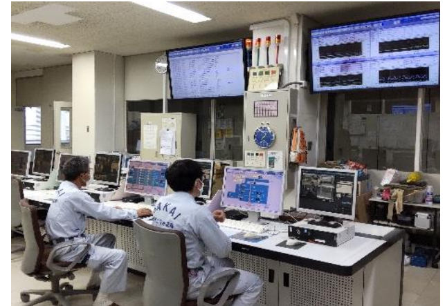
水再生センターの運転監視状況
