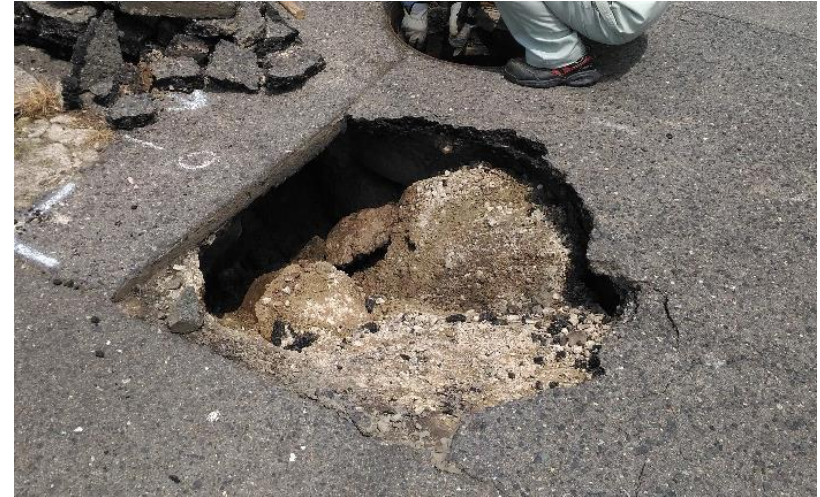
陥没事故写真
