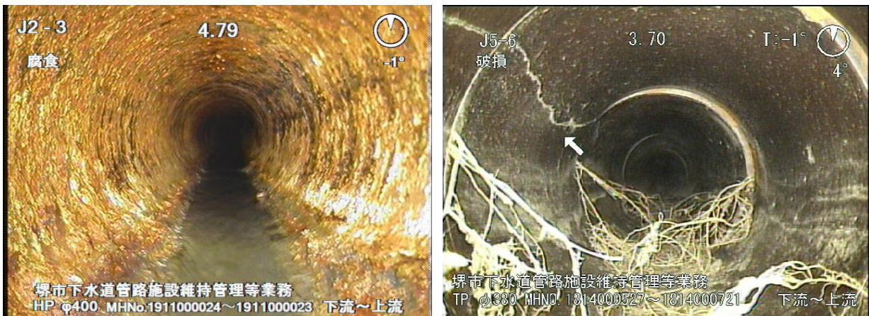
図 管きよの老朽化の状況
