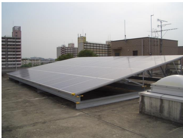
太陽光発電設備（泉北下水処理場）
