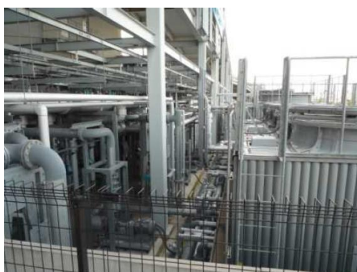
下水再生水熱利用システム
