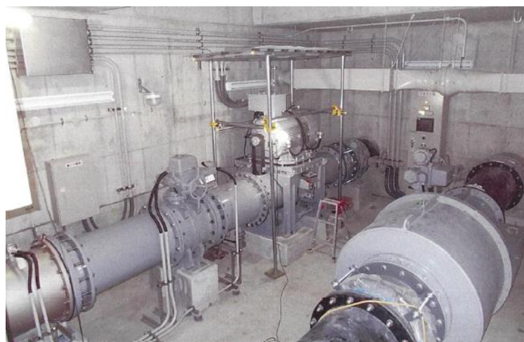
陶器配水場内の小水力発電設備
