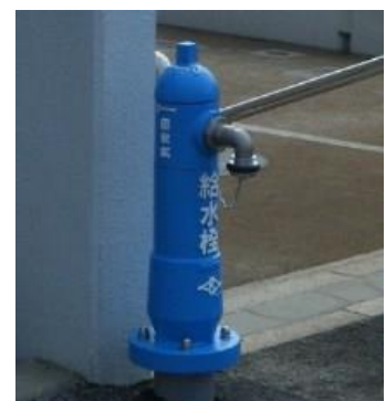
災害時給水栓写真(出典:仙台市)
