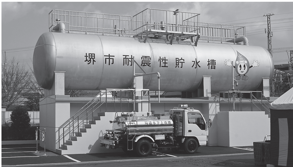
本庁舎敷地内の耐震性貯水槽
