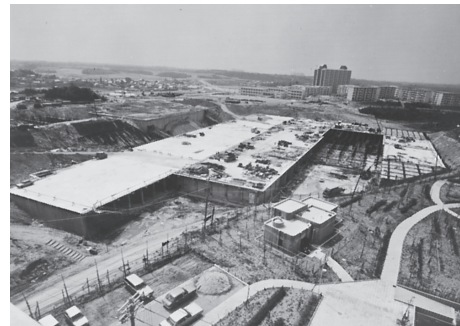
泉ヶ丘第3配水場（現・桃山台配水場）
