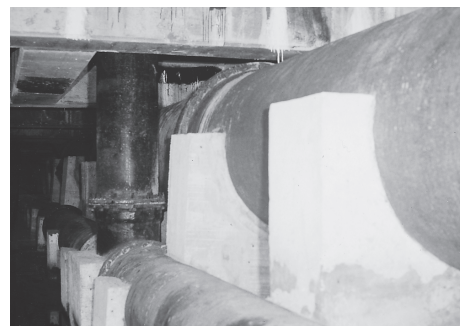
泉ヶ丘第3配水場（現・桃山台配水場）内の受水管
