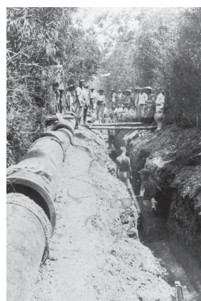
大阪市からの分水受水のための浅香山浄水場から大和川南岸までの導水管布設工事（大正13年）
