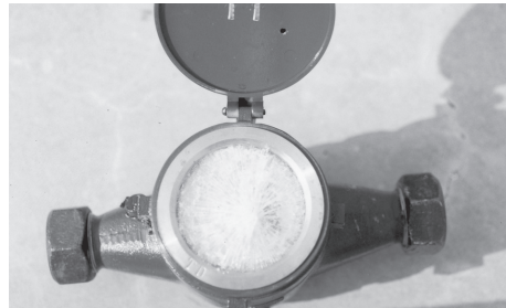
異常寒波で破損した水道メーター
