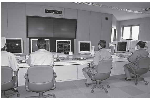
配水管理センター内部
