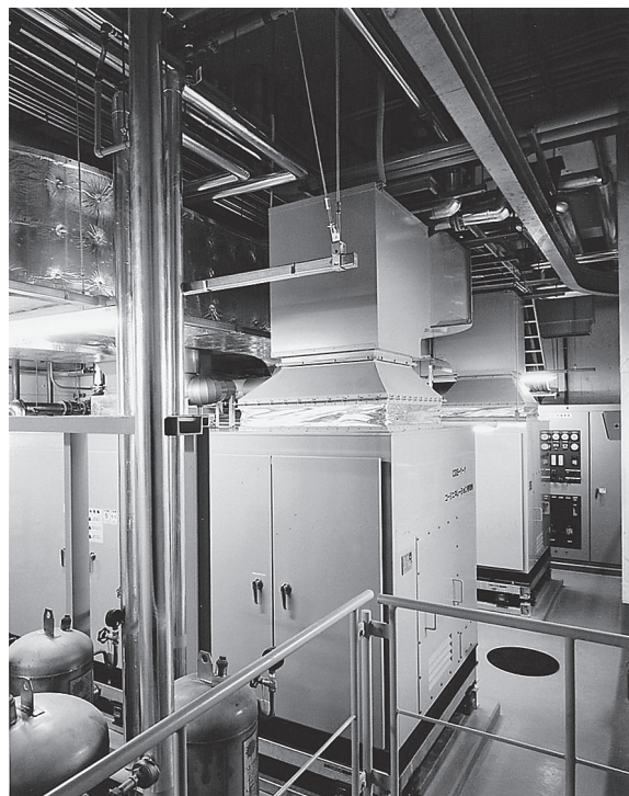
ガスコージェネレーションシステム
