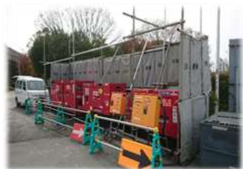
今池No.3、今池No.4に設置した発動発電機
