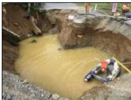
今池水みらいセンターでの陥没調査状況
