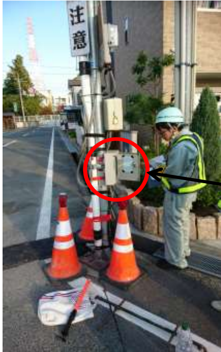
場外NO. 1 水位計 位置
