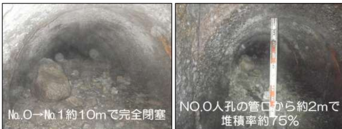
今池水みらいセンター内に布設している堺市公共下水道管 (金岡東線：口径 1,200 mm) の破損による下水道管の管路内閉塞状況
