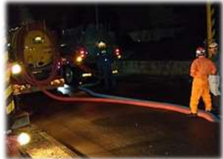
今池水みらいセンター場内での バキューム車による吸引状況
