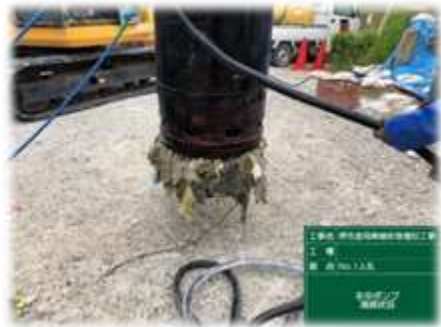
雨水ポンプに付着した堆積物
