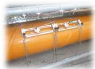
仮設ポンプ送水管に設置した流量測定器
