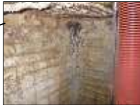
鉄筋が露出している状況
