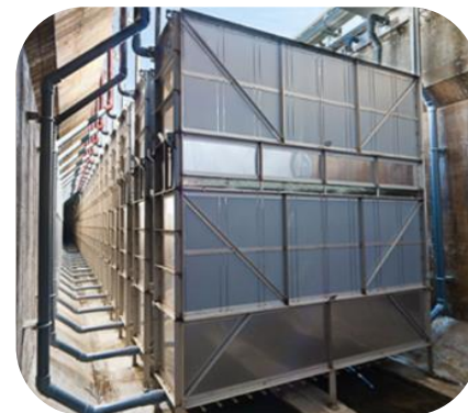
膜移設前の三宝下水処理場での設置状況
