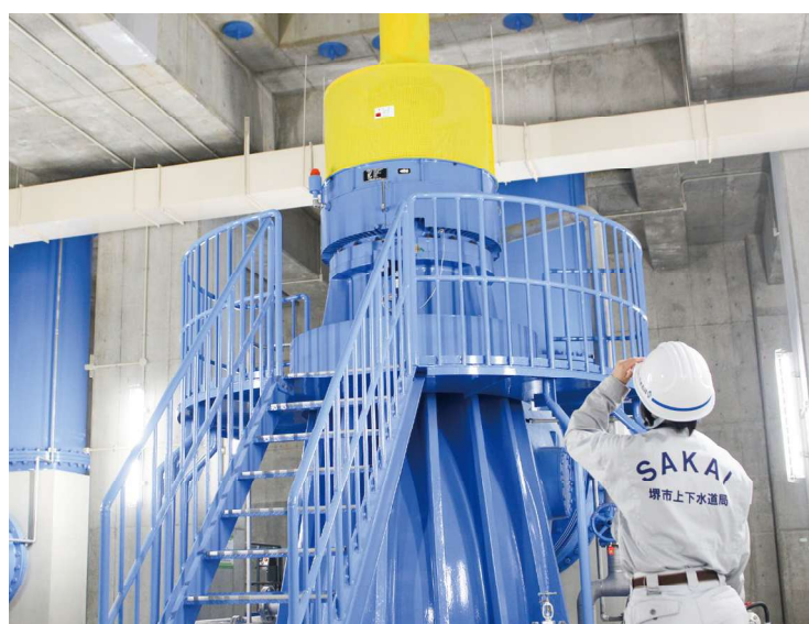
▲古川下水ポンプ場の大型ポンプ このポンプ一台で、1分間に25mプール約4杯分の水を排水できます。
