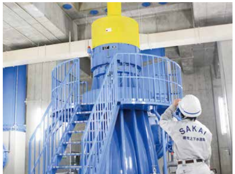
▲古川下水ポンプ場の大型ポンプ このポンプ一台で、1分間に25mプール約4杯分の水を排水できます。
