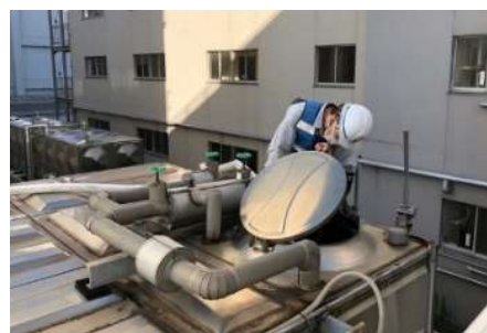
▲貯水タンクへの給水
