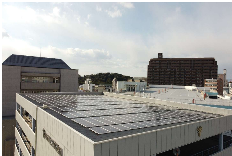
▲本庁舎駐車場棟屋上の太陽光パネル
