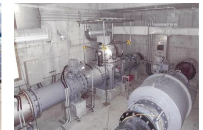
小水力発電 （陶器配水場）
