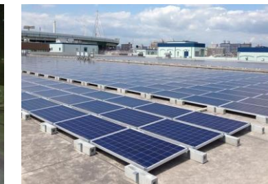
太陽光発電 （三寶水再生センター）
