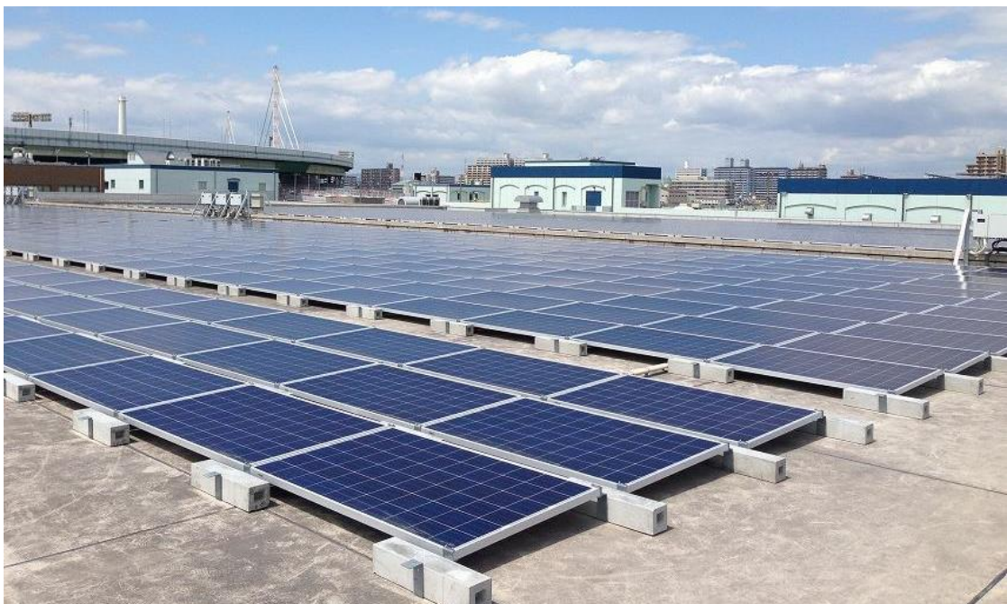
三宝下水処理場 太陽光発電設備
