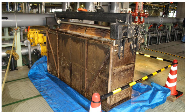
泉北下水処理場 MBR 膜ユニット (点検のため反応タンクから拔出)
