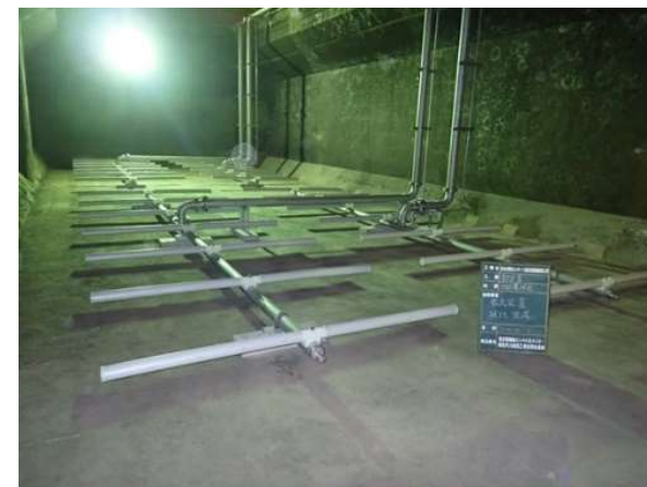
低圧損メンブレン形式散気装置 (泉北水再生センター)
