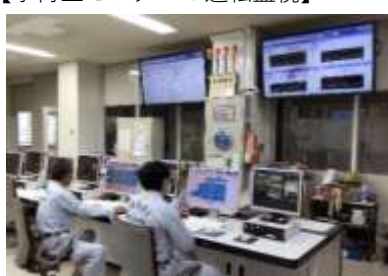
【水再生センターの運転監視】
