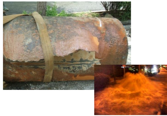
南区若松台（口径800mm） 大規模漏水事故（2012年）
