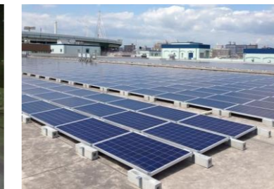
太陽光発電 （三寶水再生センター）
