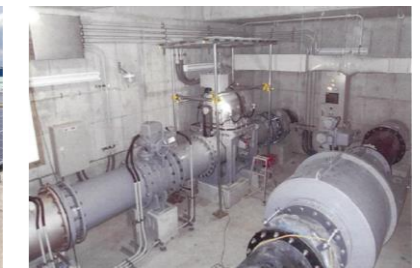
小水力発電 （陶器配水場）
