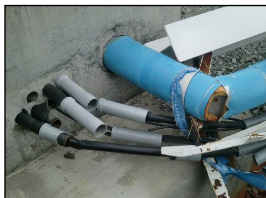
破損した川原川橋水管橋
