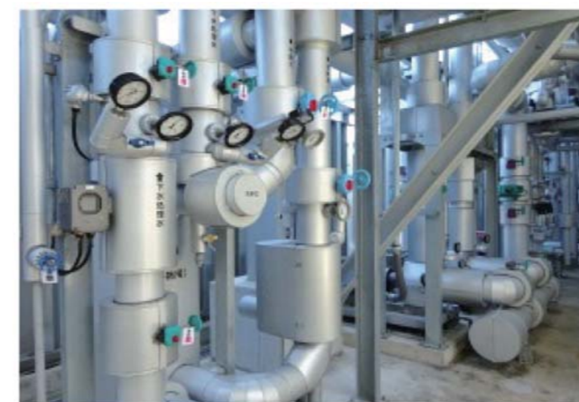
大型商業施設内の熱交換器
