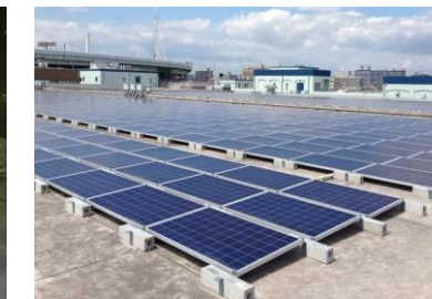
太陽光発電 (三寶水再生センター)
