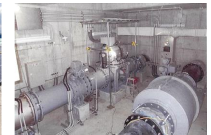
小水力発電 (陶器配水場)
