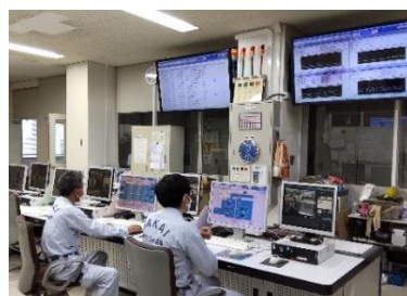
【水再生センターの運転監視】
