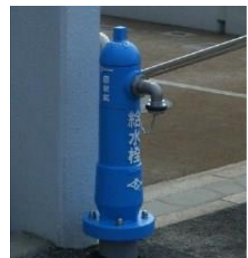
災害時給水栓写真(出典:仙台市)
