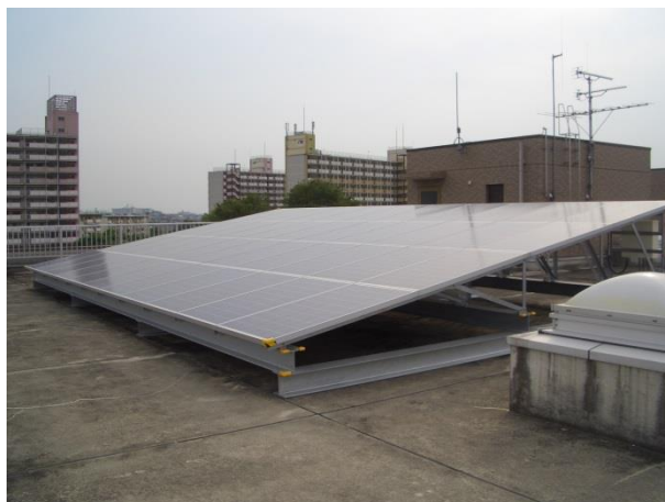
太陽光発電設備（泉北下水処理場）
